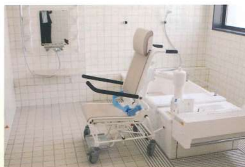
通所介護棟【特殊浴槽】
