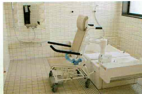
通所介護棟【特殊浴槽】
